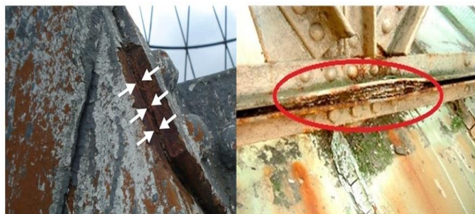
Фиг. 3. Пукнатинна корозия [9–10]
