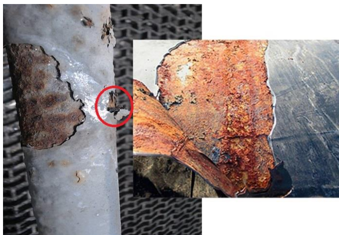
Фиг. 5. Подповърхностна корозия
